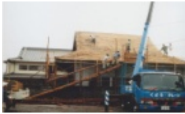
屋根瓦が全部剥がれる
